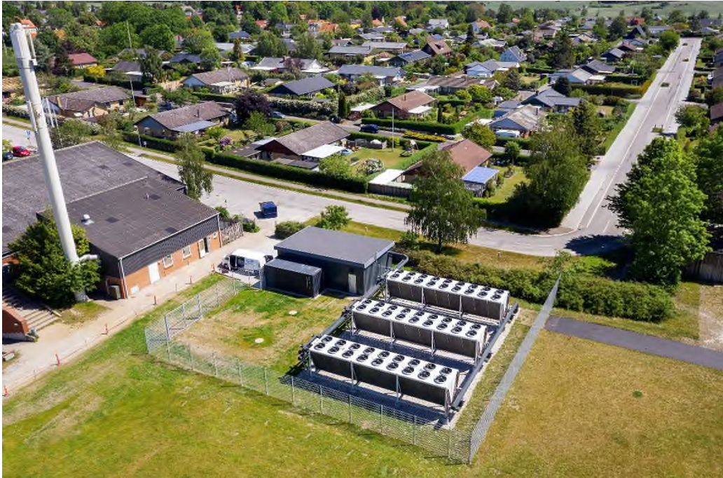
Abbildung 16: 1-MW-Luftwärmepumpe mit Wärmequelle Luft in Slagslund, Dänemark (Urheber: PlanEnergi)
