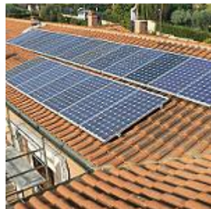
INSTALACIÓN SOLAR FOTOVOLTAICA
