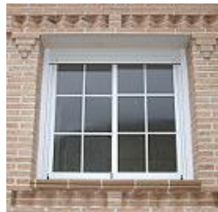
MEJORA DE CERRAMIENTOS ACRISTALADOS
