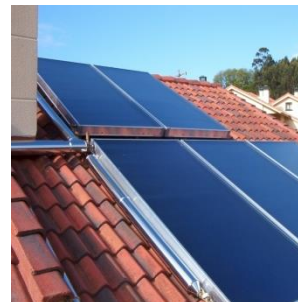
INSTALACIÓN SOLAR TÉRMICA
