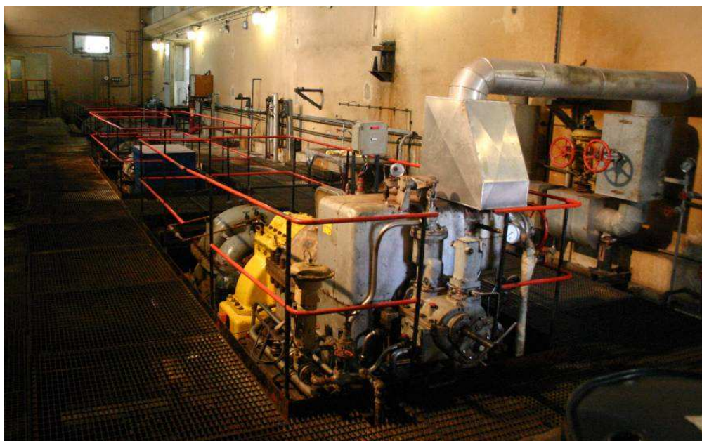
Slika 61 Pumpna stanica morske vode u Rafineriji nafte Rijeka
