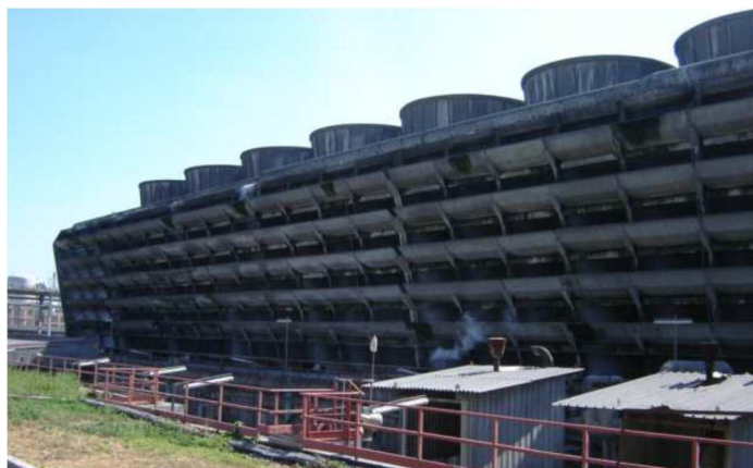
Slika 57 Rashladni tornjevi iz Faze 2
