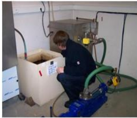
Bac de décantation
