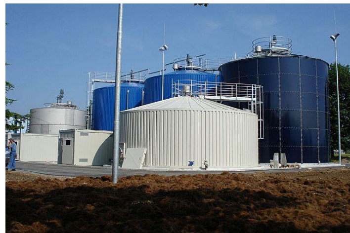
Biogas complex «Rassvet», 4,8 MW, Mogilev region
