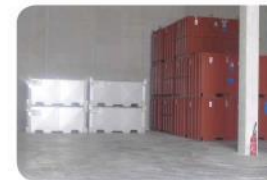
2 Entreposage des colis de déchets selon leur propriété radiologique (débit de dose)
