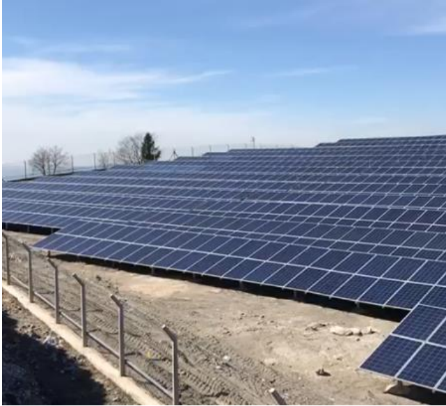
4,6 MW solar modules in Turkey (Bursa).
